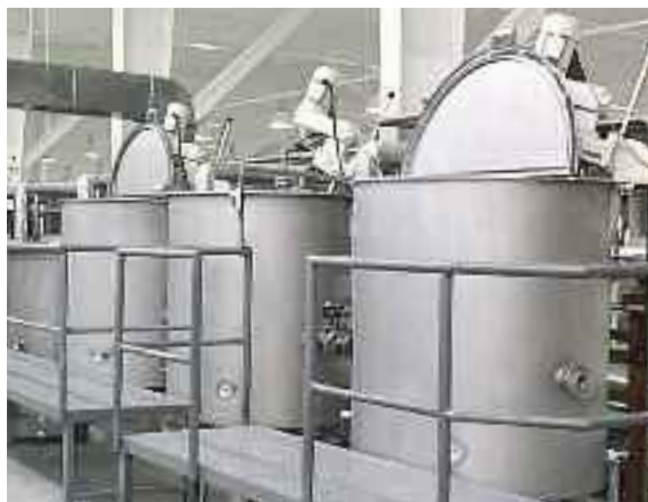
Preparation tank Ansatzbehälter
